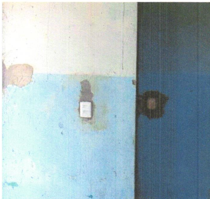
FOTO 01 – INTERRUPTOR SIMPLES (1 MÓDULO), 10A/250V INCLUINDO SUPORTE E PLACA – FORNECIMENTO E INSTALAÇÃO. AF 12/2015
